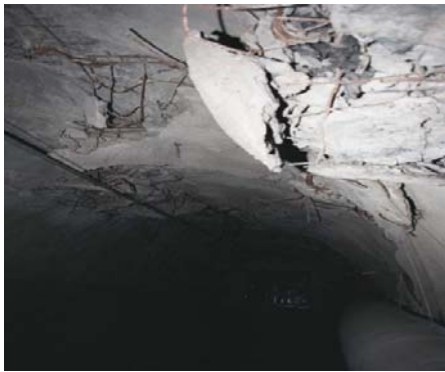
(b) 锚喷失效
