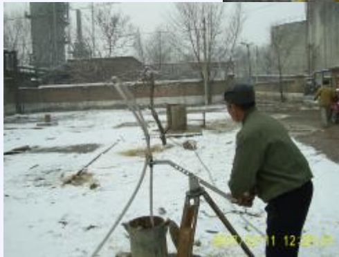
手动惯性泵洗井
